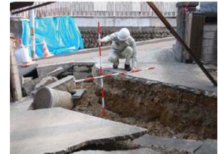
緑ヶ丘4丁目地区の被災状況
