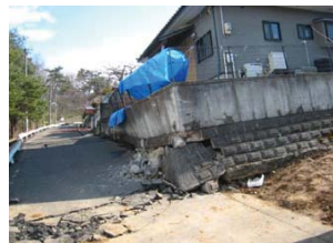
折立5丁目地区の被災状況
