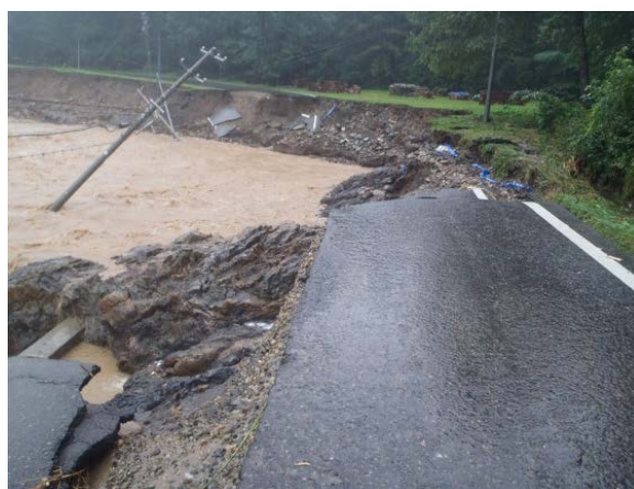
写真2 関東・東北豪雨の道路崩壊
