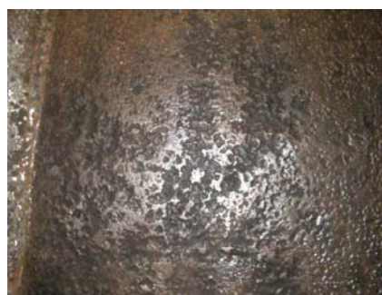
写.9 トラフ底面部損傷状況
