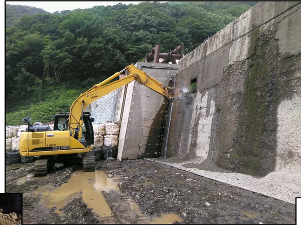
重機 (バックホウ) を用いてコンクリート表面処理をした縮減例 (竜川第2砂防堰堤: 施工中)
