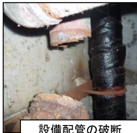
設備配管の破断
