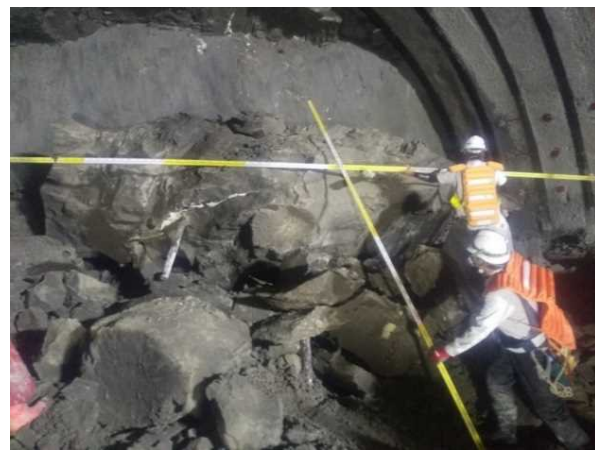
▲施工途中の切羽崩壊状況 (今泉第二トンネル)
