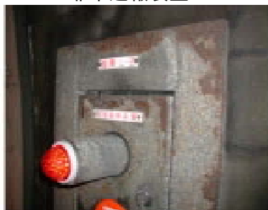
非常通報装置
