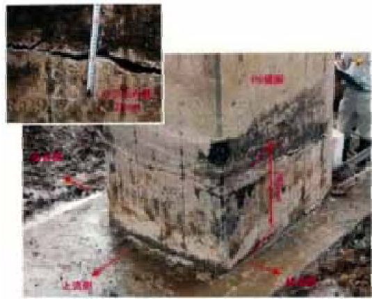
H15.7宮城県北部地震で被災した事例
