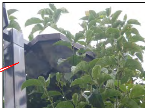
外灯器具と樹木が接触している
