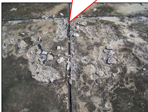
コンクリート表面が劣化して剥離
