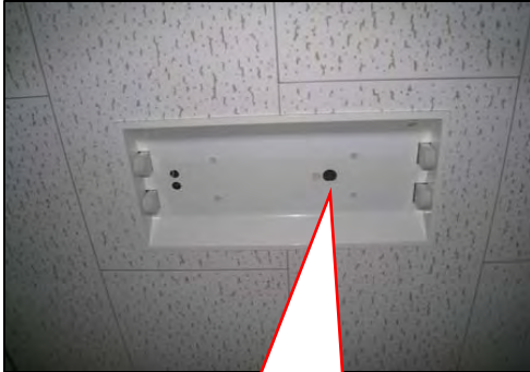
非常用の電球が外されている
