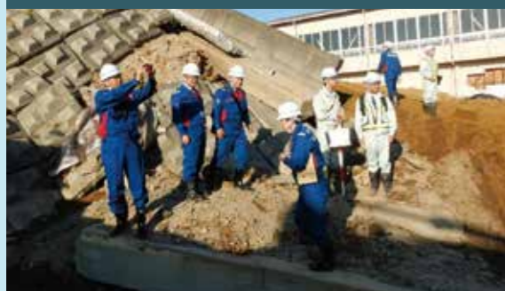
堤防決壊箇所調査状況
