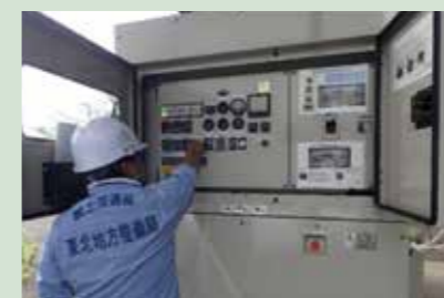
▲排水ポンプ動作確認状況
