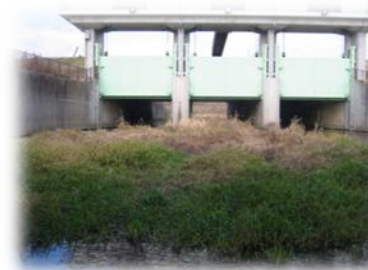
堆積土砂の撤去
