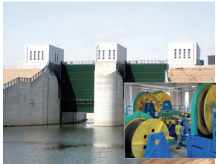
水門ゲート設備
