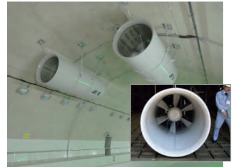
トンネルジェットファン
