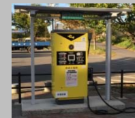
(EV急速充電器 H24.1~)
