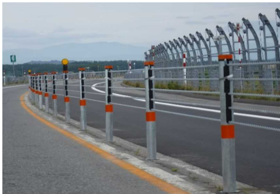
▲ワイヤロープ式防護柵設置状況
