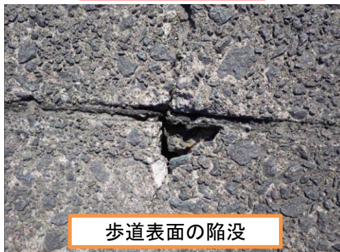
施設老朽化状況
