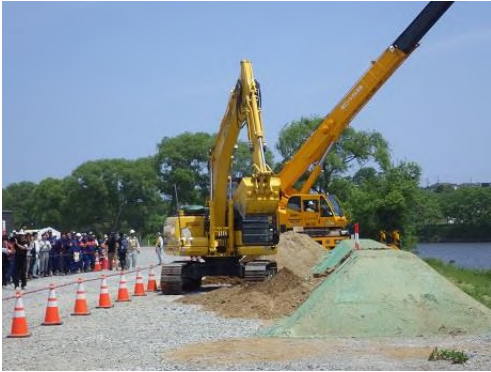
▲建設業協会、国交省による 被災箇所への応急復旧訓練の様子
