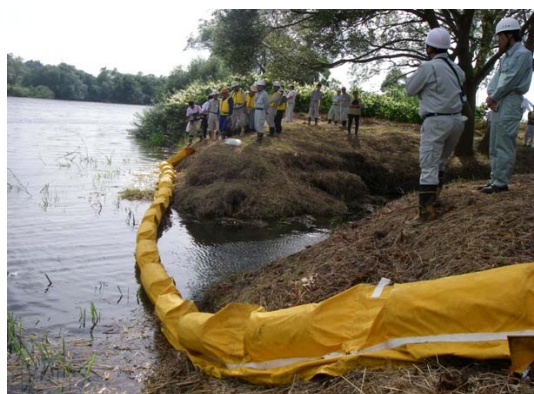
水路と馬淵川の合流部分に「オイルフェンス」を設置。本川への被害拡大を防ぎます。
