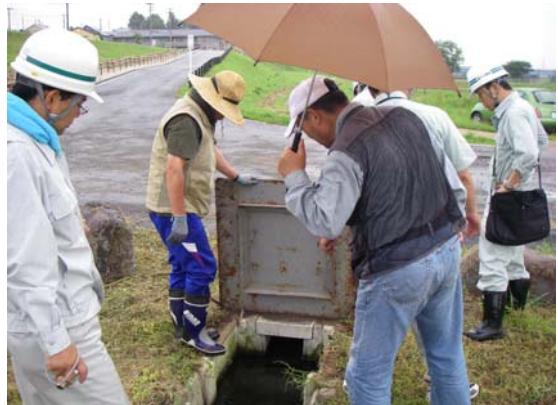
「水辺の楽校」のせせらぎ水路。拵ふたの取付けの状態や内部について確認。
