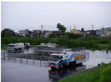
浅水川排水樋門の「排水ピット」と「排水ポンプ車」
