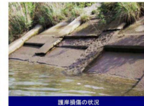
護岸損傷の状況
