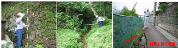
(H20.7.24 岩手北部を震源とした地震) 【出典：東北地方整備局】
