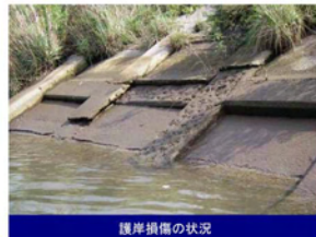
護岸損傷の状況
