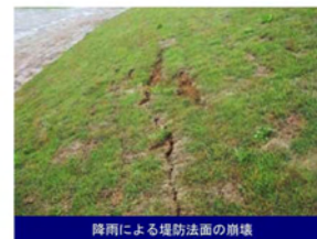
降雨による堤防法面の崩壊
