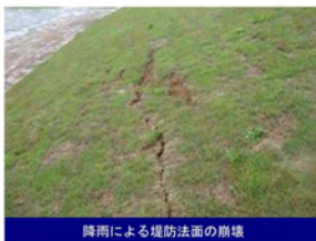
降雨による堤防法面の崩壊
