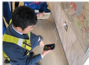
▲ 非常用コンセント通電状況確認
