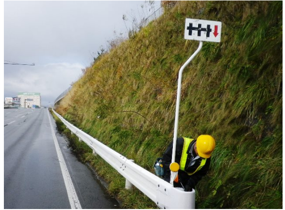
▲除雪作業による施設の損傷を防ぐための標識(防護柵があることを示す標識)
