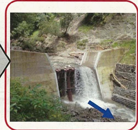
土石流発生直後 (H27.9.11)
