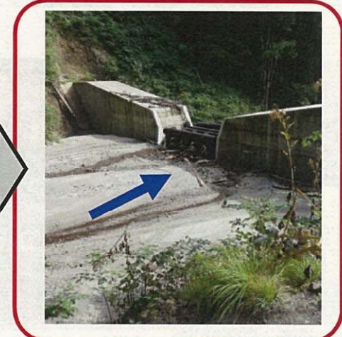
土石流発生直後 (H27.9.11)
