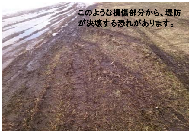
【タイヤで踏み荒らされ傷んだ堤防の法面】(H27.2)
