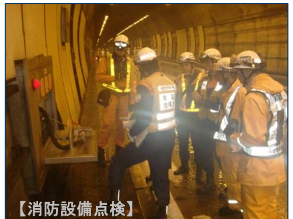
【消防設備(水噴霧)点検】
