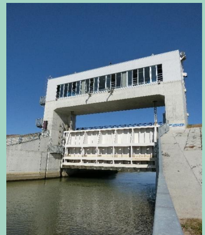
■水門開閉確認
