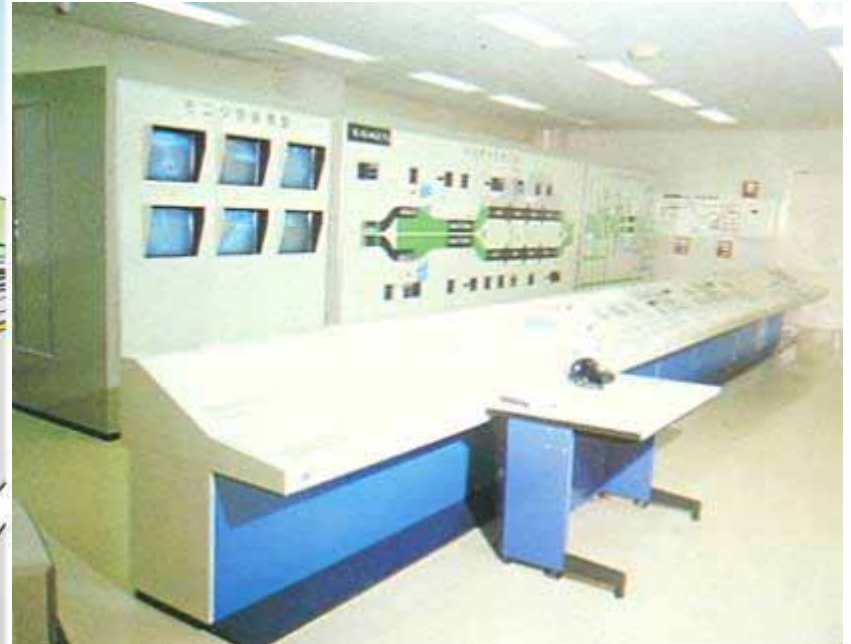
国道48号仙台西道路 集中監視室
