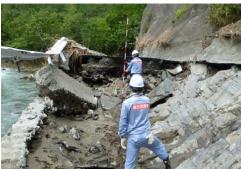
▲ 被災状況調査
