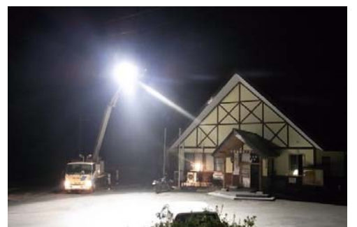
▲ 避難所への照明車設置
