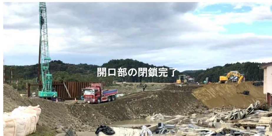
仮堤防盛土による開口部閉鎖完了 (仮堤防盛土は継続施工、19日完了予定。鋼矢板による締切施工中)
