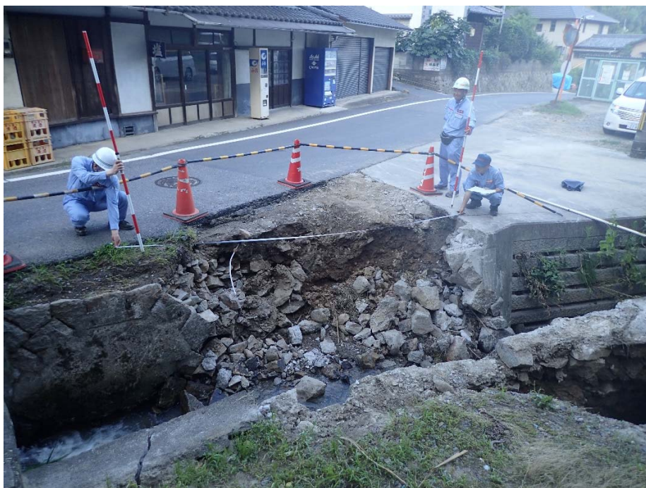
被災状況の調査の様子
