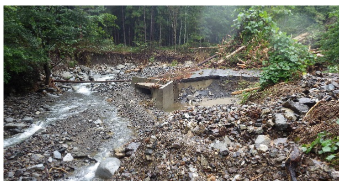
9/13 流失した道路の状況
