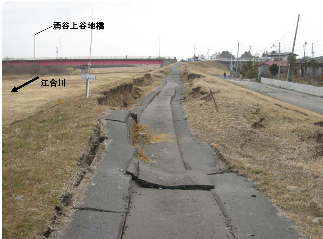
3月15日堤防被災状況 堤防沈下
