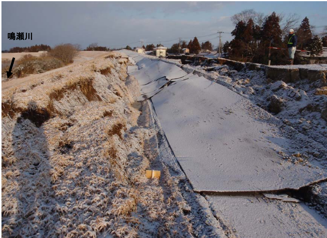
3月12日堤防被災状況 堤防沈下・斜面の崩れ
