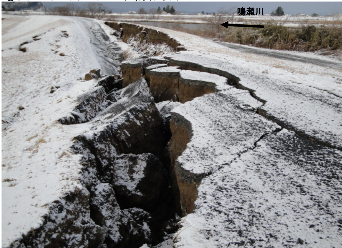
3月12日堤防被災状況 堤防沈下
