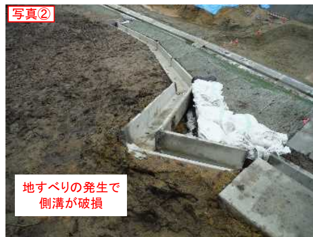
▲地すべりによる側溝の破損
