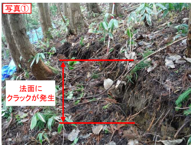
▲地すべりによるクラックの発生
