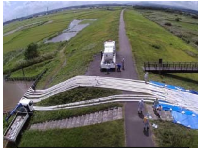
内水排水状況 (H29 秋田市仁井田)
