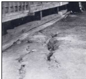
S33年頃 ひきまき 引牧の住居軒下の開口亀裂
