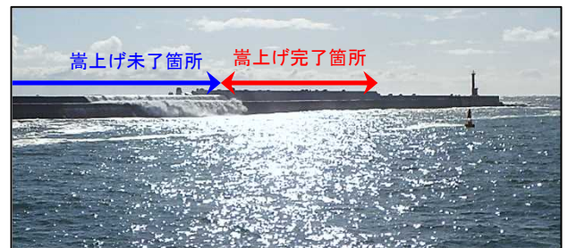
▲未施工箇所の越波状況
