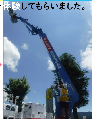
災害対策用の照明車も動かしてみました。
