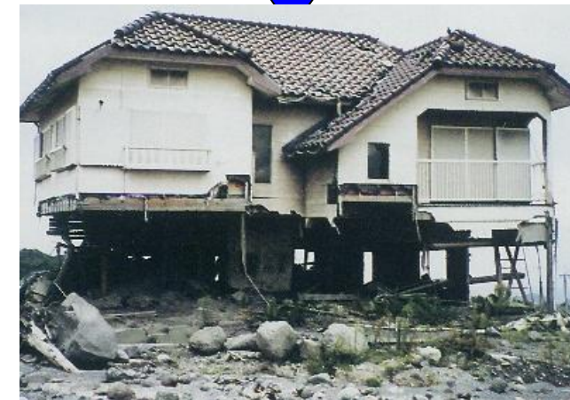
土石流による家屋被害(雲仙)
