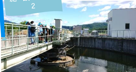
汚れた水をきれいにし、川へ戻す 白鷹町浄化管理センター
