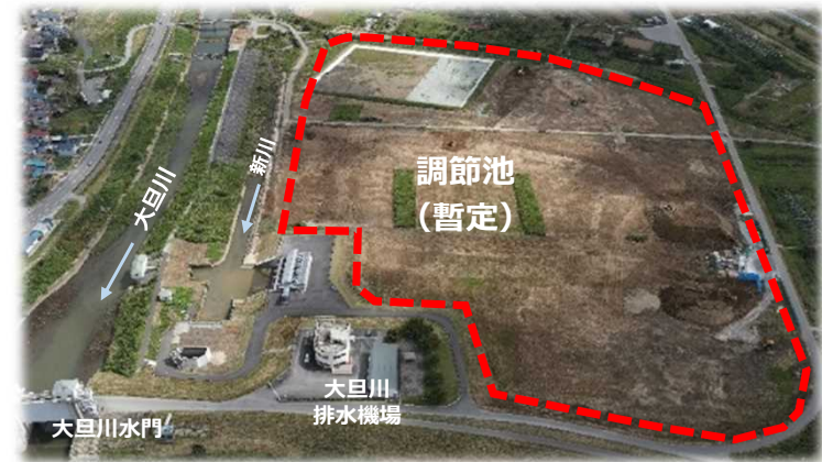
調節池整備状況
