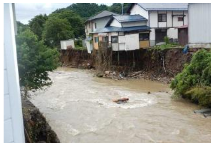
山形市長谷堂 本沢川 護岸破損
