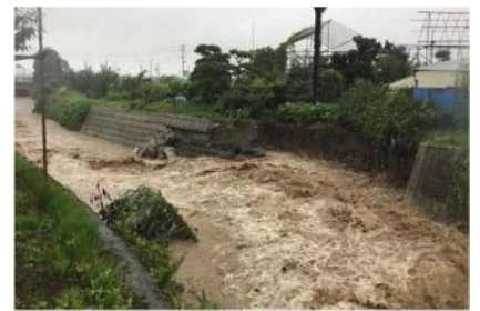
山形市門伝 富神川 護岸破損
