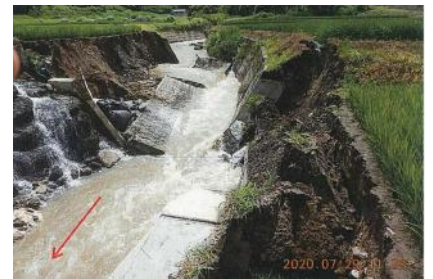
舟形町堀内 松橋川 護岸破損
