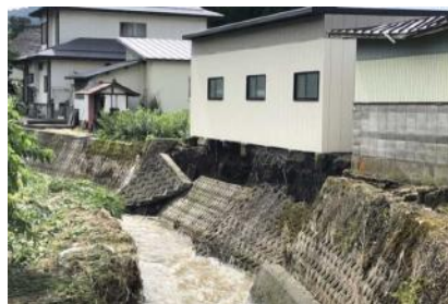
上市市下生居 生居川 護岸破損
