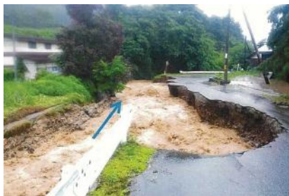
白鷹町滝野 荒砥川 護岸破損
