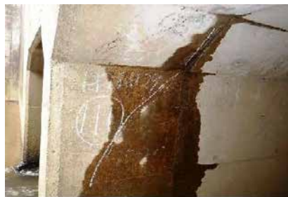
樋管・樋門の漏水状況
