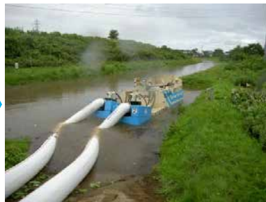
排水ポンプ車による排水 (王川排水樋門)
