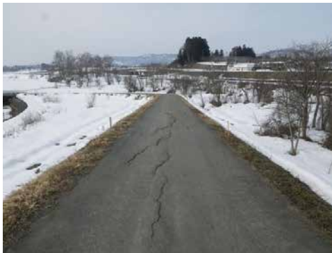
堤防の天端舗装補修前の状況
