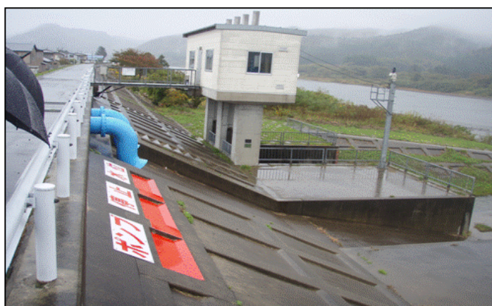
比井野川排水機場のポンプ運転停止水位の表示状況
