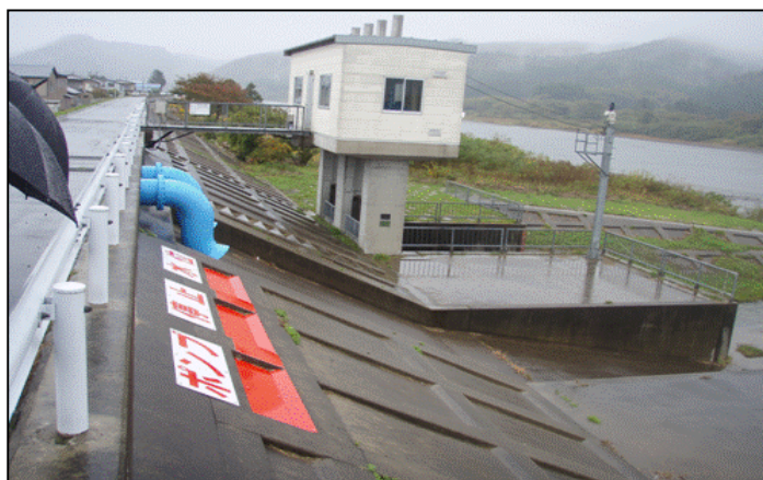
比井野川排水機場のポンプ運転停止水位の表示状況
