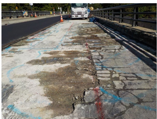
写真4-5 【損傷】床版ひびわれ
