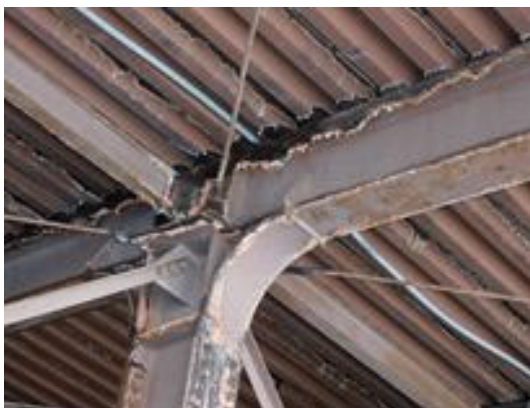
写真4-20 【損傷】 主構上部（頂版）腐食
