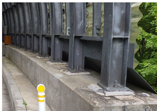
写真4-17 【損傷】 沓座モルタルの破損、うき
