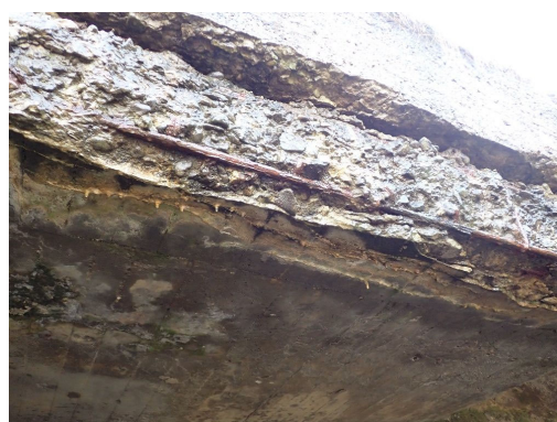
写真4-23 頂版の剥離・鉄筋露出
