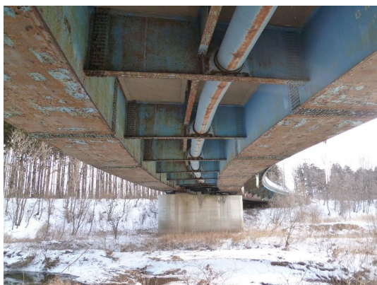
写真4-8 【損傷】主桁の腐食
