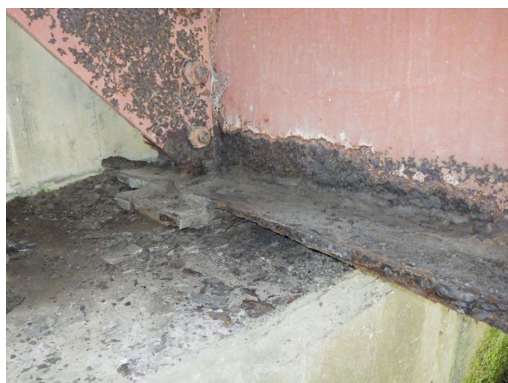
写真4-22 主桁端部の腐食
