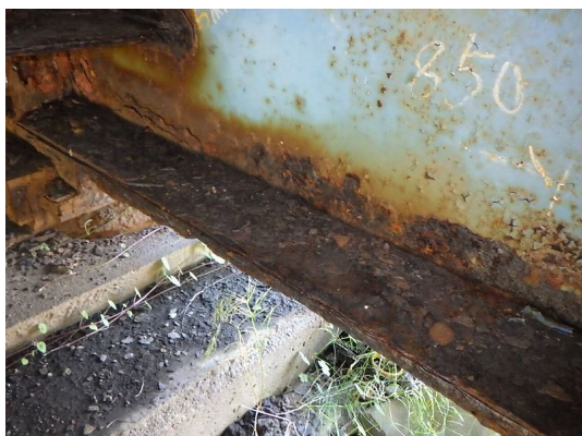
写真4-11 【損傷】主桁の腐食
