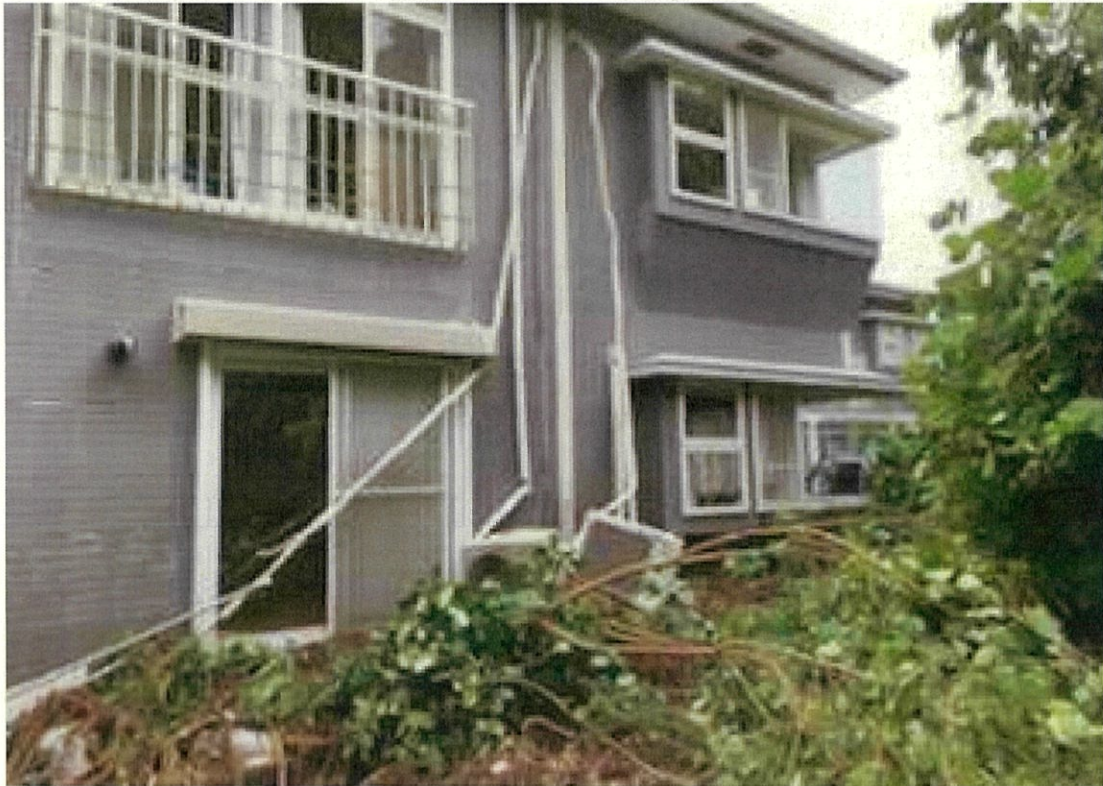
⑦宅地の土砂崩れ
