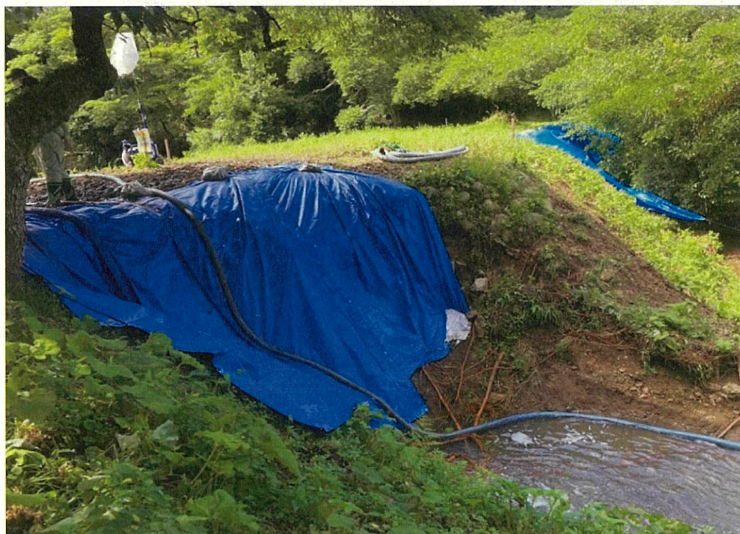
⑥防災重点ため池堤体欠落
