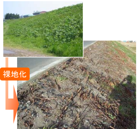
有害な植生の侵入による堤防の裸地化
