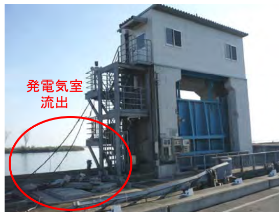
閉上水門(被災後)
