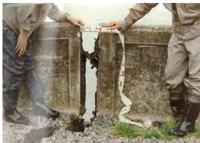
閑上特殊堤接合部の開口
