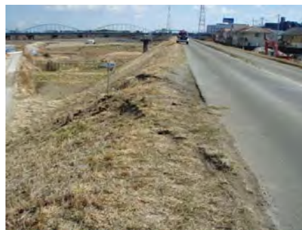
車両による堤防損傷
