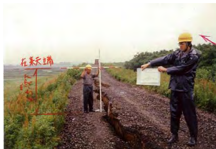
堤防の亀裂・沈下
