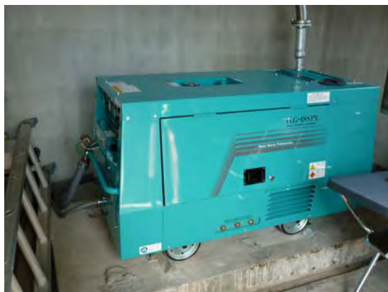
発電機設置状況(地震前)
