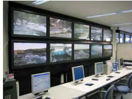
ダム放流設備制御装置
