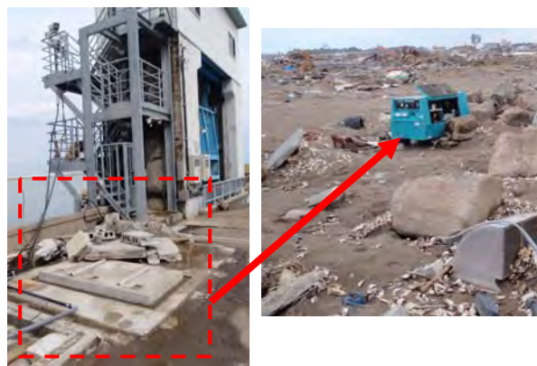
津波による発電機の流出状況
