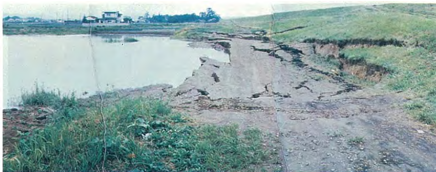
閑上堤防裏法面のすべりによる亀裂
