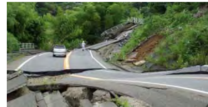
被災状況調査
