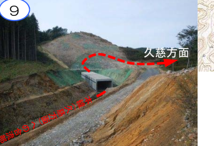
(仮称)田野畑ICから久慈方面に向かって本線へ合流する道路付近です。本線部や宮古方面への出口道路の工事を今後整備します。
