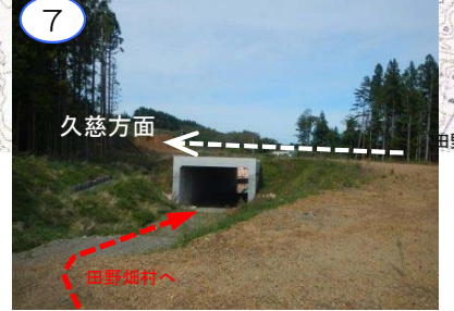
宮古方面から来た車両が(仮称)田野畑ICで田野畑村へ出る道路付近です。本線部や宮古方面への入口道路の工事を今後整備します。
