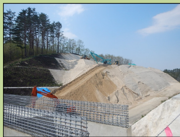
滝ノ沢工区の切土・土砂運搬状況。→現在「完了」しています。
