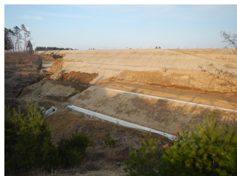
斜面の側溝です。(H30. 3)
