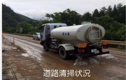
流出物撤去状況
